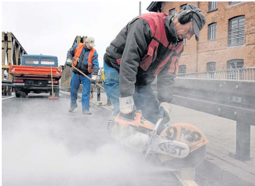
Letzte Handgriffe wurden gestern an der Behelfsbrücke im Zuge der Demminer Straße über die Gleise getan. Heute um 10 Uhr soll sie, wie das Straßenbaumittelteil, für den Fahrzeugverkehr als auch für Radfahrer und Fußgänger freigegeben werden. FOTO: KARL-HEINZ ENGEL
